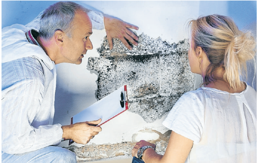
Bei einer feuchten Wand hilft nur noch eine effektive Trockenlegung.
